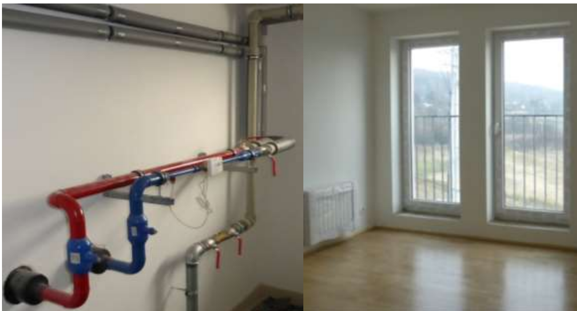
Fot 9. Wejście instalacji ogrzewania w budynku 411
