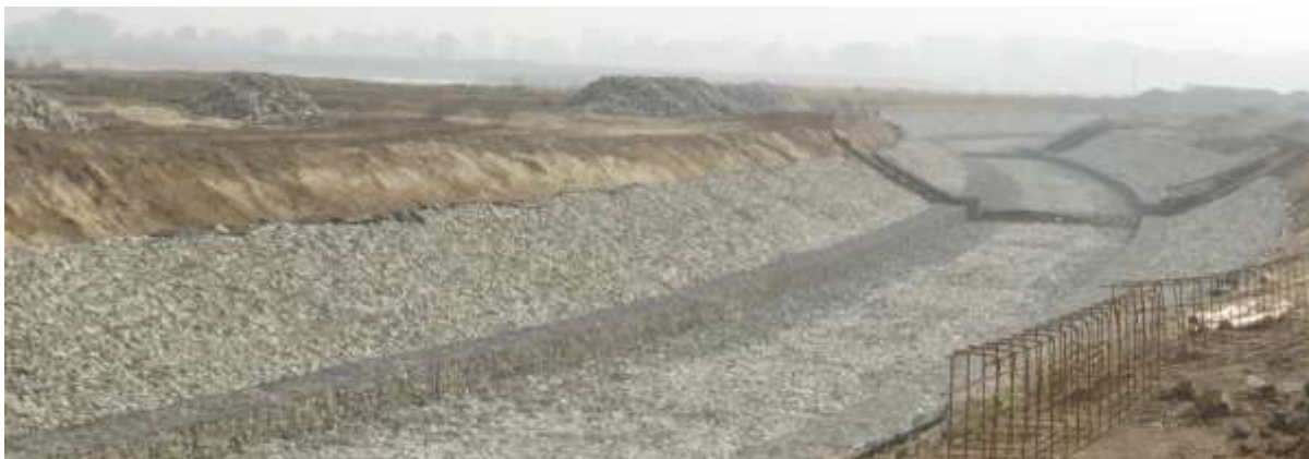
Fot 4. Wykop i umocnienie koszami siatkowo-kamiennymi koryta rzeki Psiny na terenie czaszy zbiornika.
