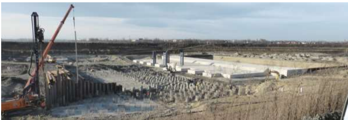
Fot 2. Wykonane wzmocnienie podłoża pod budowlę przelewowo-spustową, oraz część niecki wypadowej. Z lewej strony zdjęcia – zabijanie ścianki szczelnej od wody górnej.
